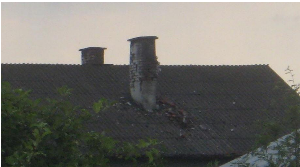
Uderzenie pioruna – zniszczony komin
