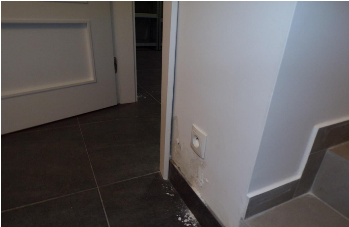
Odparzenia tynku oraz napuchnięte framugi drzwiowe po zalaniu
