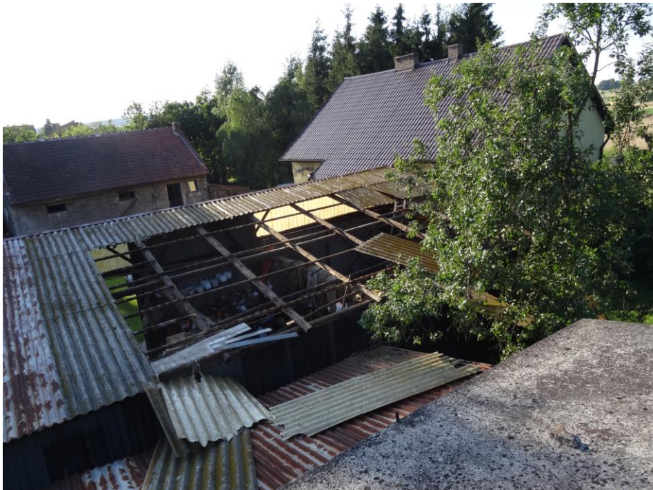
Huragan – poderwana prawie cała połać dachu, uszkodzona konstrukcja drewniana.
